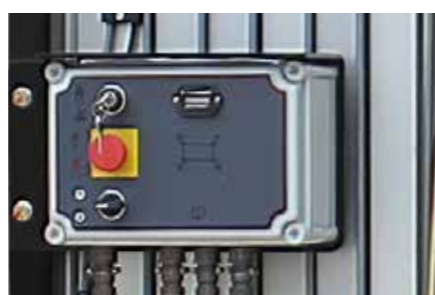
Кнопка аварийной остановки
